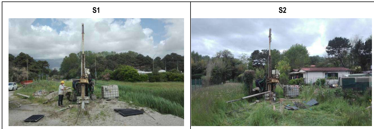
Figura n.9 - Fasi di esecuzione dei sondaggi S1, realizzato nel tratto I del Fosso Poveromo lungo la sponda destra, e S2, eseguito nel tratto III del Fosso Poveromo lungo la sponda sinistra.
